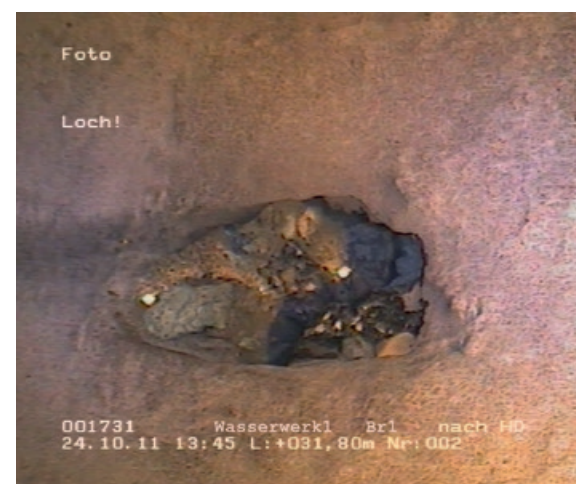
Abb. 5 – Foto eines erfassten Korrosionsschadens aus dem verlinkten Kamerabefahrungsbericht
